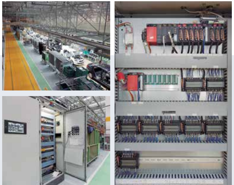
Einblick in Werk 2 von FAW Car Co., Ltd. sowie in installierte CC-Link Geräte.
